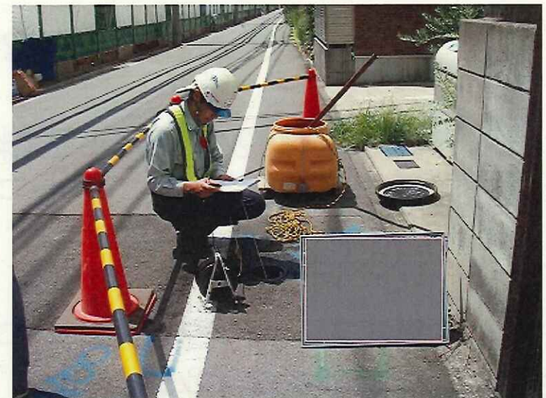
地下水位観測
