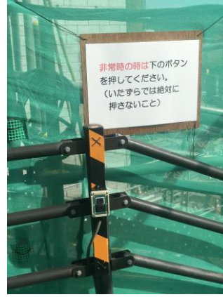
仮設階段中間に非常ボタン
